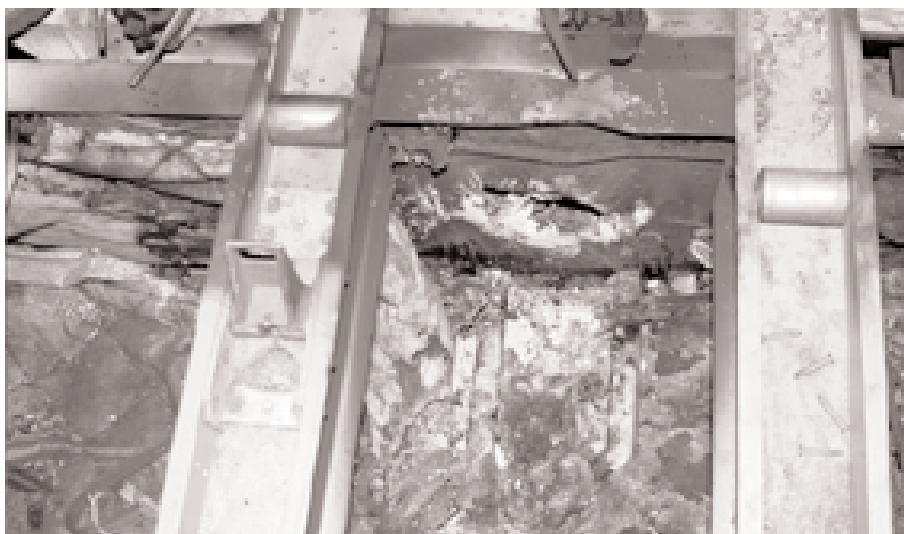
Domages résultant d'un feu causé par un ruban chauffant de conduite d'eau défectueux. Noter la distorsion de la poutre sous l'effet de la chaleur.
