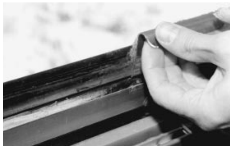
Les fenêtres d'issue de secours sont équipées d'une petite poignée de métal qui limite la force qu'on peut y exercer, et les fenêtres se coincent dans le cadre.
