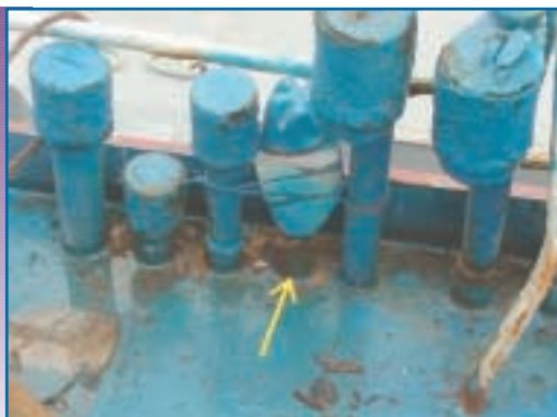
Tête d'un conduit de ventilation remplacée par une bouteille en plastique de deux litres
