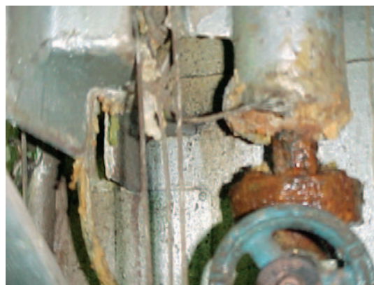
Valve de chaudière
