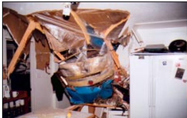
Les dommages intérieurs montrent comment les deux occupants furent [relativement] chanceux.
