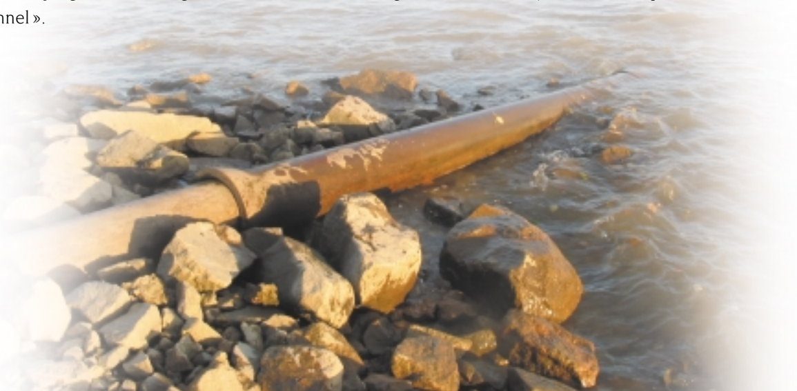
Rejets d'eaux usées municipales, Côte-Nord
