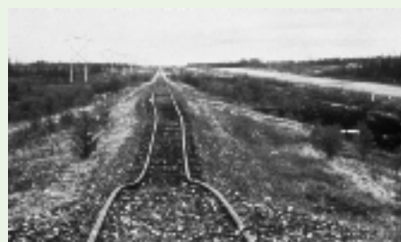
La fonte du pergélisol peut fragiliser les structures au sol comme les voies ferrées.
