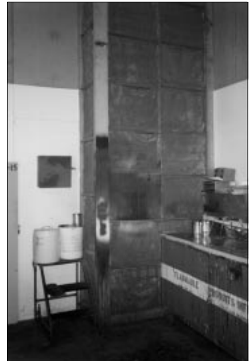
Filtres secs sales et détériorés d'une cabine de peinture à Gagetown.
