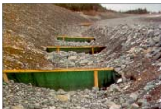
Barrières en géotextile perméable assurant la protection d'un point bas.
