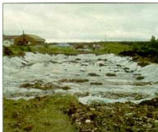
Bassin de décantation avec membrane de plastique
