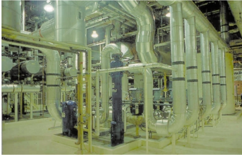
Tuyauterie d'alimentation et groupe de filtration au Centre
