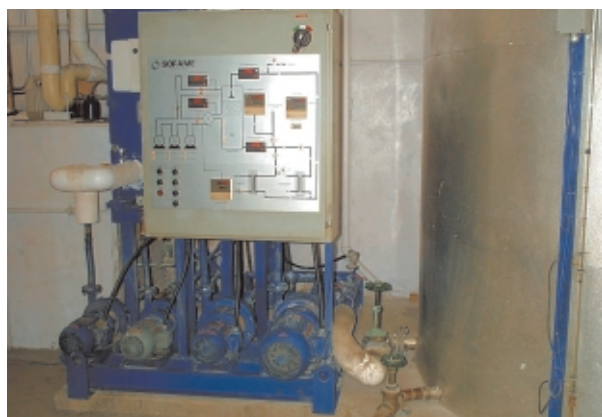
Récupérateur à contact direct
