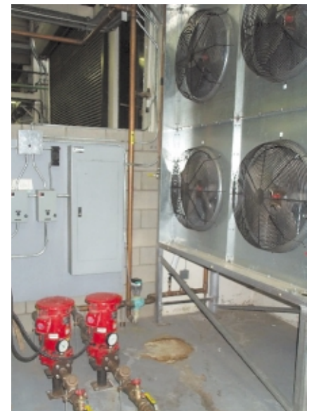
Figure 1 – Serpentin de ventilateur, pompes et vanne mélangeuse à trois voies
