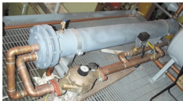
Figure 3 – Échangeur de chaleur d'eau froide domestique
