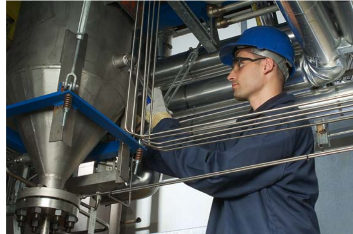
Les scories sont séparées des gaz de synthèse à l'intérieur de la cuve de trempage.
