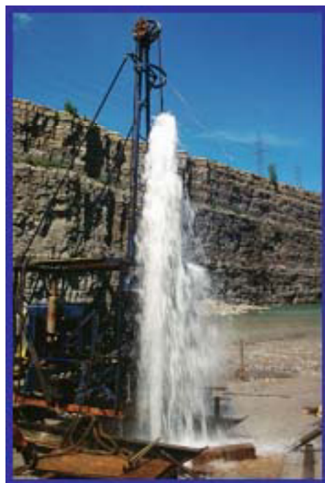
Artesian well in Southwestern Quebec / Puits artésien dans le Sud-Ouest du Québec
