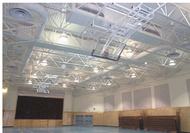
Figure 1 – Éclairage de gymnase classique
