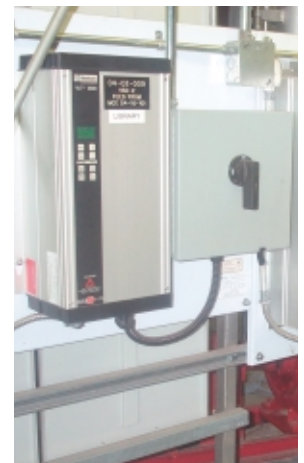
Figure 1 – Panneau de commande de mécanismes d'entraînement classiques à fréquence variable
