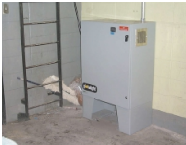
Régulateur de l'éclairage à l'extérieur
