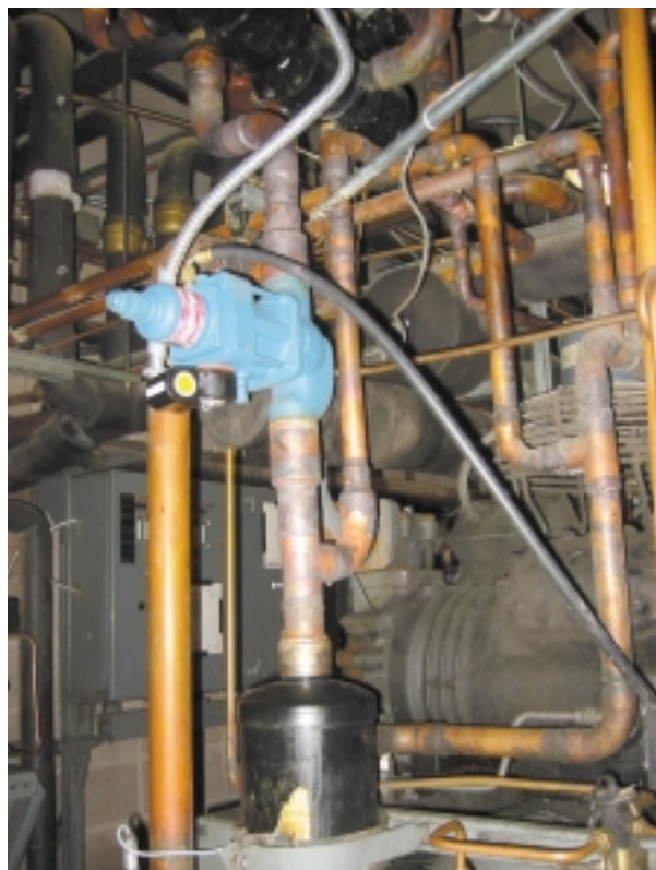
Commandes de réduction de la pression de refoulement dans le système de compresseur de réfrigération
