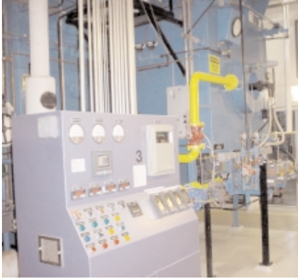
La salle des chaudières
