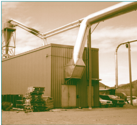
Bâtiment qui abrite le système de combustion de la biomasse (vue de face) – Au-dessus du bâtiment, une série de conduits transportent la poussière de ponçage du dépoussiéreur à sacs filtrants jusqu'au silo à l'arrière. Le grand conduit partant du devant du bâtiment transporte l'air chaud jusqu'à l'installation de production. L'évent de décharge, qui est utilisé les journées chaudes, se trouve près du coude où le conduit s'élève vers le haut.
