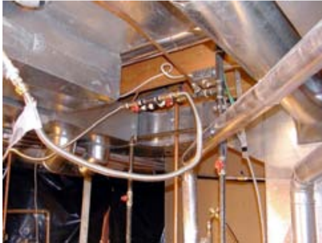
Tuyaux de gaz flexibles non fixés servant à l'alimentation des systèmes de production de CO 2 . (Photo 12)
