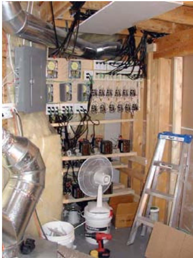
Panneau électrique secondaire alimenté par une dérivation électrique et des transformateurs placés sur les tablettes du bas. Remarquez le ventilateur servant à refroidir ces transformateurs. (Photo 7)
