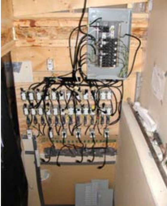
Autre panneau électrique secondaire alimenté par la dérivation électrique. Des câbles électriques à découvert, dans une cage d'escalier étroite, représentent un risque d'électrocution. (Photo 8)
