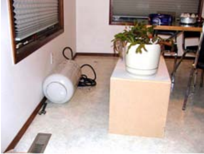
Bouteille de propane de 30 lb, retrouvée couchée sur le côté et dissimulée sous une banquette de cuisine. Le tuyau de gaz traverse le plancher pour rejoindre un système de production de CO 2 installé à l'étage inférieur. (Photo 14)
