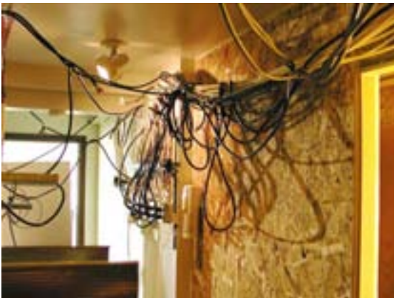
Des câbles de 220 volts suspendus et entremêlés aux tuyaux de plomberie se dirigent vers des refroidisseurs d'air à tampon humide. Cet amas de câbles présente un danger d'étranglement évident pour une équipe de pompiers devant effectuer une recherche initiale dans des conditions de visibilité réduite. (Photo 9)
