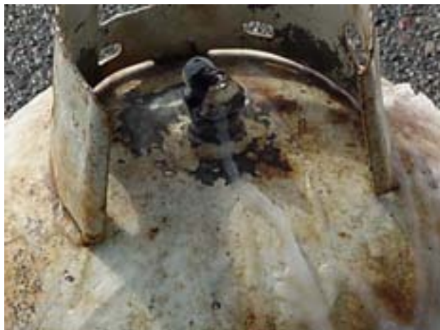
Accumulation marquée de corrosion de teinte bleu-vert sur la soupape d'une bouteille de propane, ce qui indique que son contenu est inapproprié. (Photo 20)
