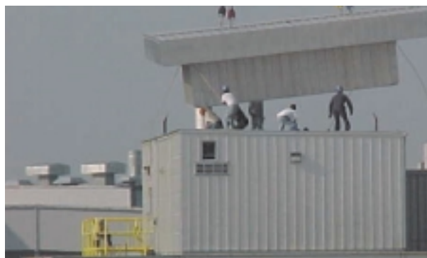
L'une des 13 unités Big Foot avec appareil de chauffage au gaz naturel est installée sur le toit de l'usine de montage de Ford à Oakville.
