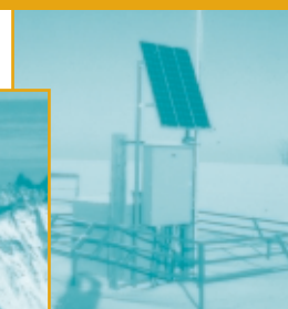
▲ Les petits systèmes PV répondent facilement aux besoins limités des systèmes de contrôle à distance (comme aux têtes de puits de gaz).
