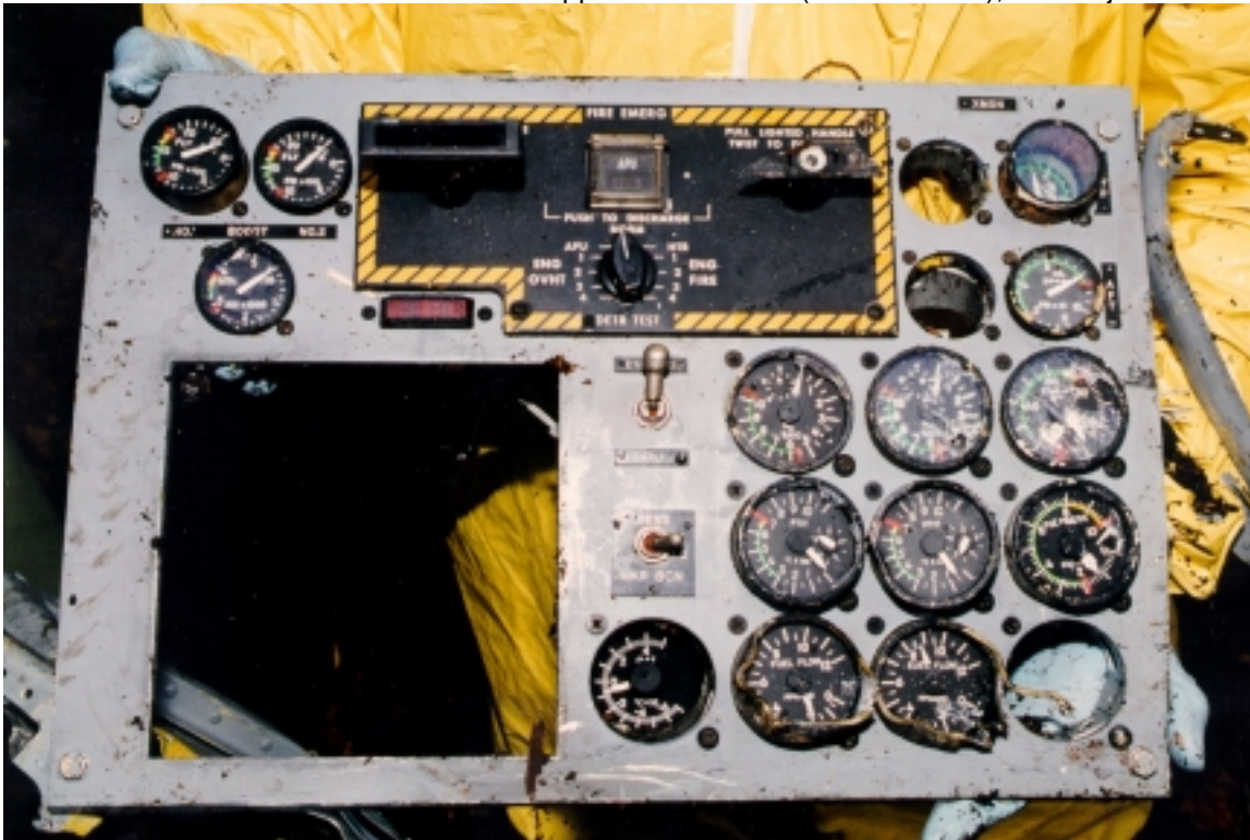
Photo 32 - Fire Extinguisher Control Panel - Note damage to Number 2 "T" handle// Panneau de commande du circuit d'extinction incendie; remarquez les dommages sur la poignée en T numéro 2
