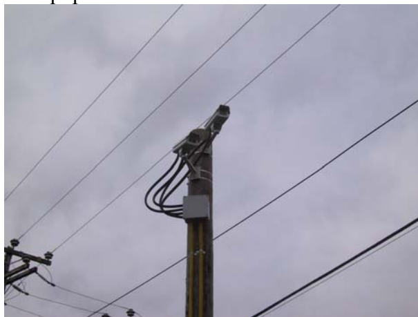
Équipement de vidéosurveillance installé
