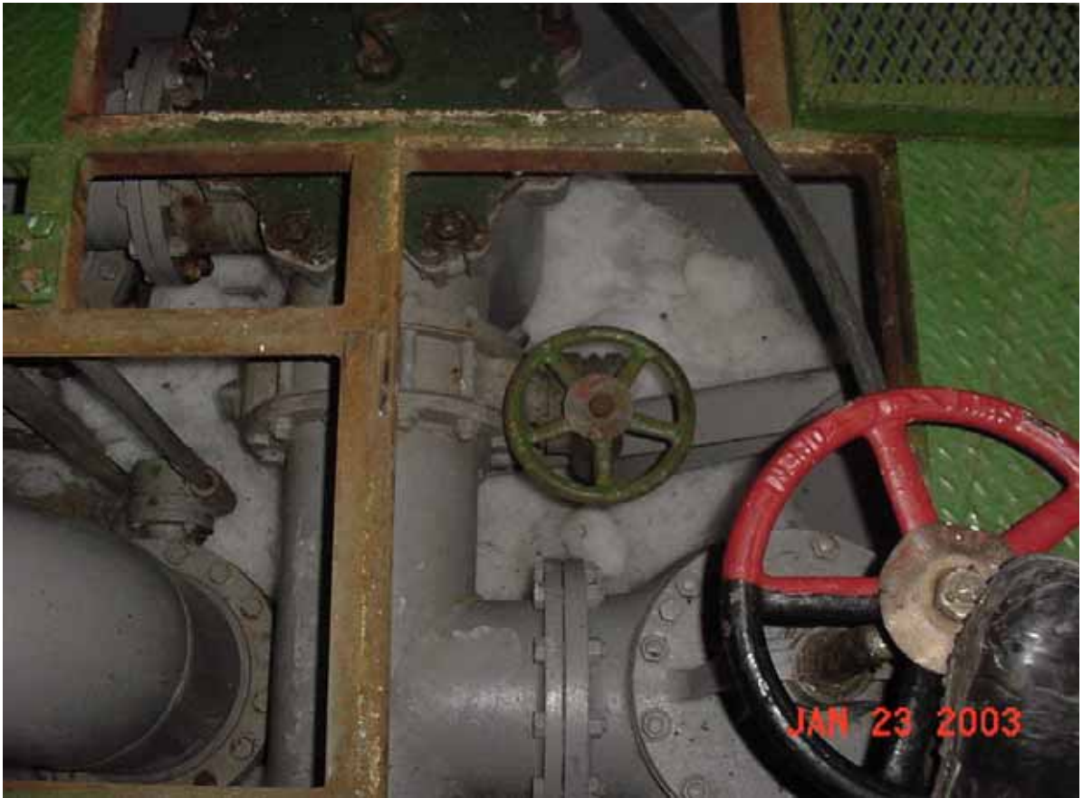
Figures 3.7A – Accumulation de glace dans les fonds de la salle des machines après de nombreux nettoyage de la crépine
