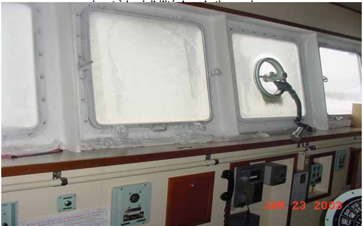
Figure 9.1B – Chauffage de la timonerie défaillant combiné à un taux d'humidité de l'air excessif
