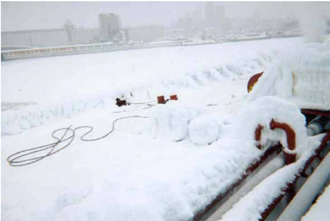
Figures 5.3F – Pont, tuyauterie et soupapes inaccessibles
