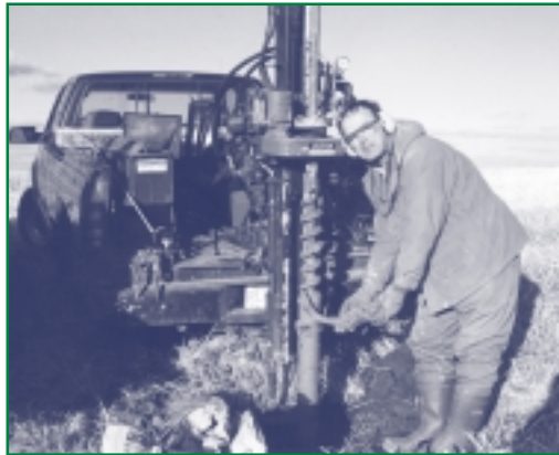
Un technicien de l'INRE installe des piézomètres— instruments utilisés pour mesurer l'ampleur ou la direction de la pression—près d'Elstow, en Saskatchewan, dans le cadre d'un projet de surveillance de la qualité de l'eau dans les Prairies.
