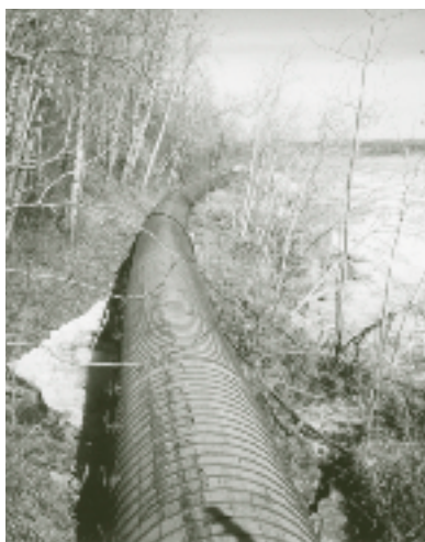
Conduite de décharge dans la rivière Winnipeg, à l'usine Pine Falls, au Manitoba.
