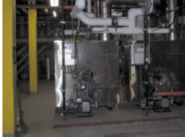
Générateur d'air chaud
