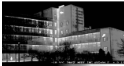
TPSGC utilise la plus récente technologie de thermographie infrarouge pour dépister les problèmes dans l'enveloppe des bâtiments.
