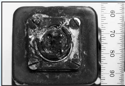
Extrémité relais du connecteur de circuit triphasé montrant les broches endommagées et le boîtier du connecteur fondu.
