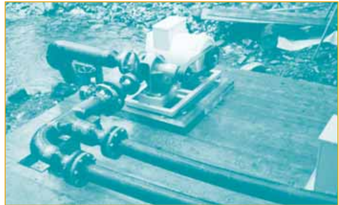
Figure 18. Turbine-pompe d'une puissance de 12 kW à doubles conduites forcées de 10 cm (4 po) (photo – gracieuseté de Thompson and Howe Energy Systems Inc.)
