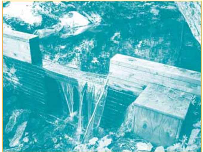
Figure 12. Prise d'eau d'un microsysteme de 2 kW (photo – gracieuseté de Homestead Hydro Systems)
