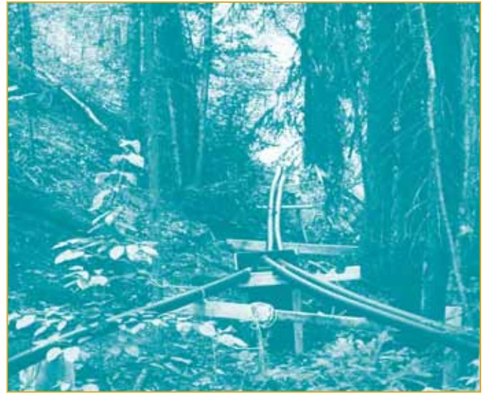
Figure 15. Conduite forcée en PEHD de 10 cm (4 po) à doubles parois d'un système de 8 kW
