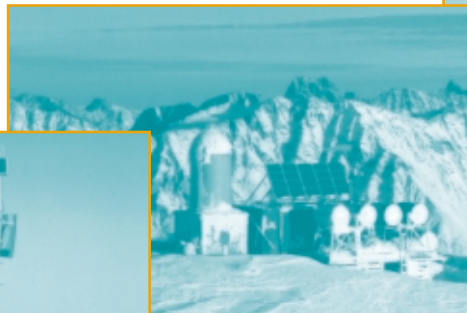
▲ En raison de l'éloignement des répéteurs, les télécommunications comptent parmi les premières applications de l'énergie photovoltaïque – c'est encore à ce jour l'une des plus courantes. Photo gracieuseté de Northwest Inc.
