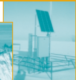
▲ Les petits systèmes PV répondent facilement aux besoins limités des systèmes de contrôle à distance (comme aux têtes de puits de gaz).
