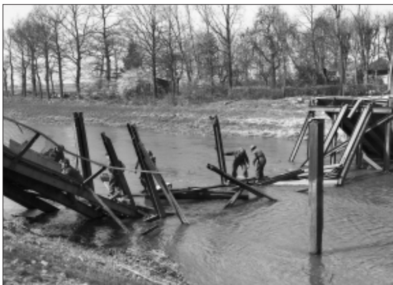
DES HOMMES DU BLACK WATCH REGIMENT CONSTRUISENT UN PONT DE FORTUNE SUR LA RIVIÈRE REGGE PRÈS D'OMMEN, 10 AVRIL 1945. (ARCHIVES NATIONALES DU CANADA 49639)
