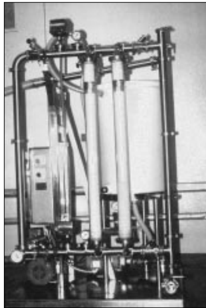
Système de filtrage à membrane pour la récupération de la matière sèche du lait.
