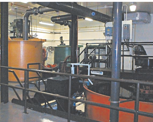
L'usine de traitement d'arsenic, vue de l'intérieur.
