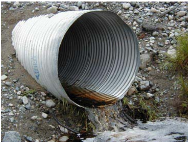
Ponceau mal installé causant la formation d'une chute Source : Ministère des Transports
