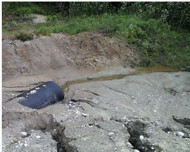
Érosion d'un talus à proximité d'un ponceau
