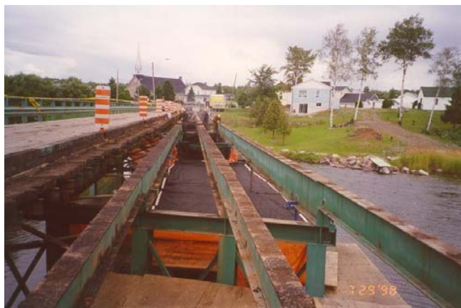
Décapage d'un pont et une toile installée sous celui-ci pour recueillir les particules de peinture
