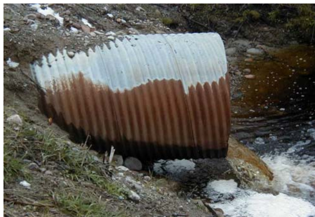
Ponceau entravant la remontée du poisson Source : Ministère des Transports
