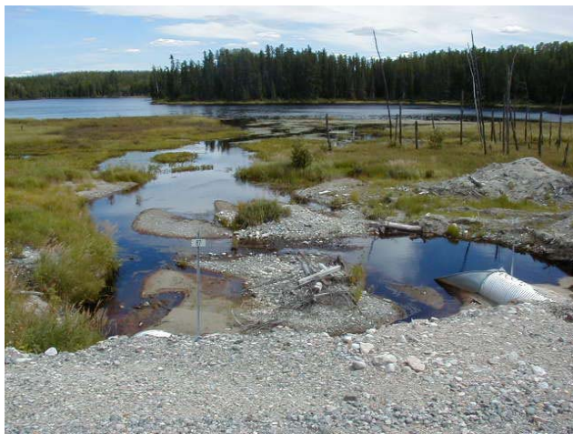
Érosion d'un talus mal stabilisé entraînant des sédiments dans le cours d'eau, qui se retrouveront dans le lac
