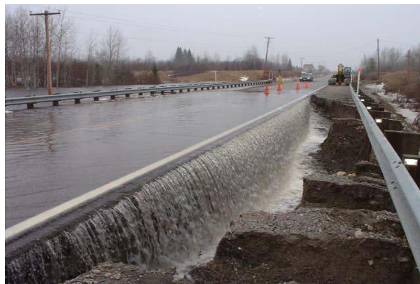
Des dommages importants à la route peuvent survenir lorsqu'un ou plusieurs barrages successifs cèdent en période de crue printanière
