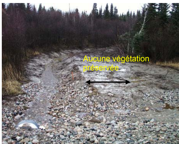
Creusage d'une décharge soumettant le sol à l'érosion Source : Ministère des Transports
