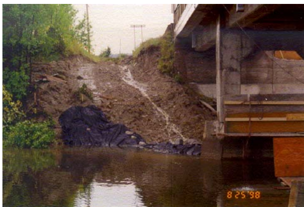
Eaux de ruissellement non détournées qui entraînent des sédiments dans le cours d'eau
