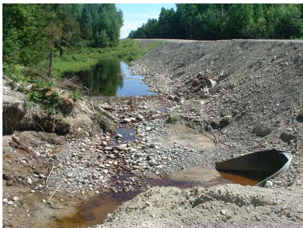
Ponceau bloqué par l'apport de sédiments d'un talus Source : Ministère des Transports
