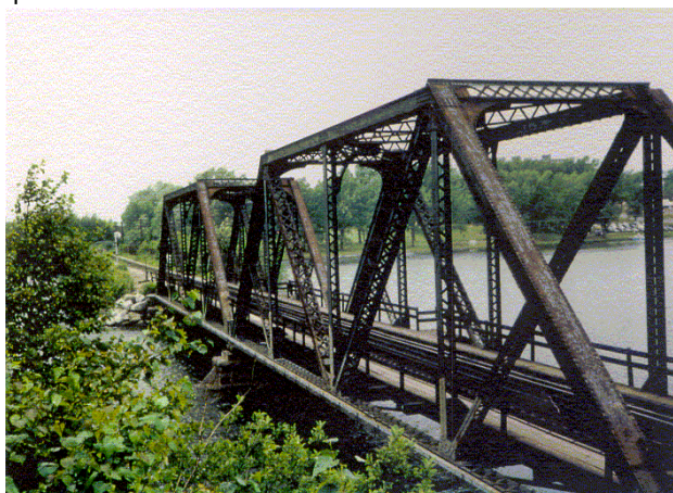
Pont dont l'armature métallique nécessitera un décapage Source : Ministère des Transports (1992)
