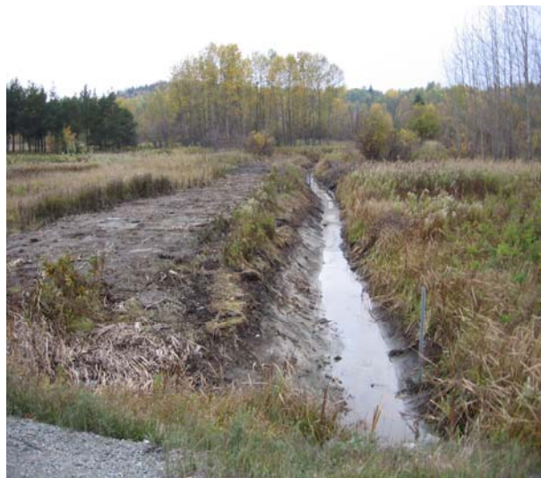
Creusage d'une décharge avec une bande de végétation d'un mètre Source : Ministère des Transports
