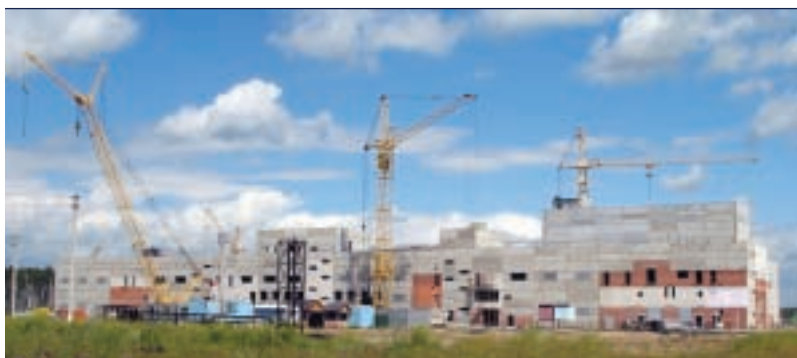
Второй главный производственный корпус завода по уничтожению химического оружия в городе Щучье
