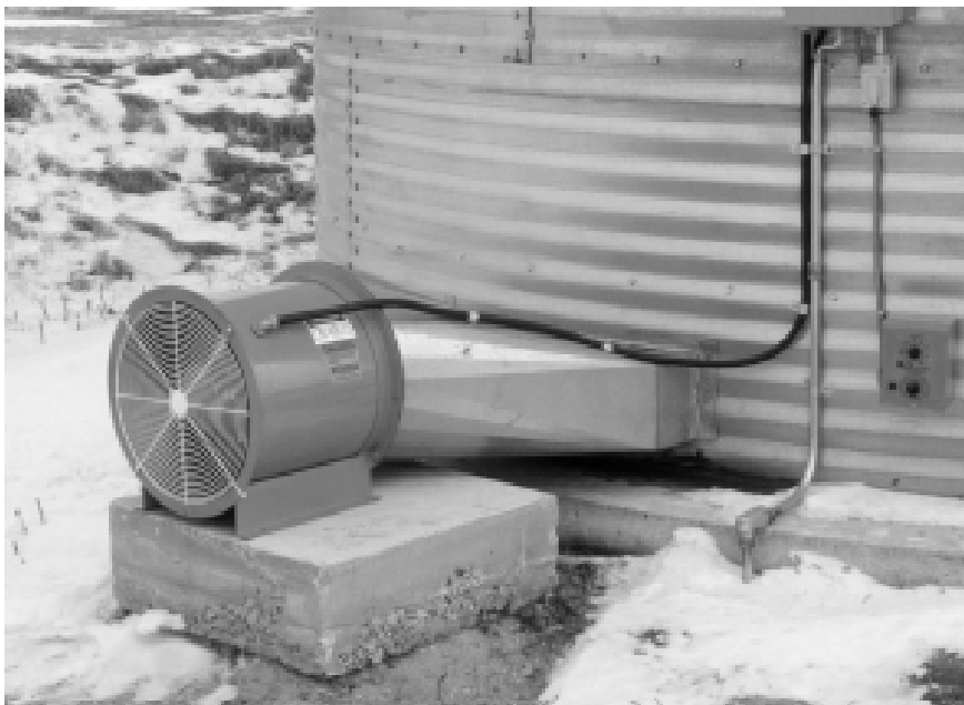
Figure 2. Unité de ventilation.
