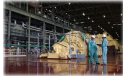
Étage des turbines de Bruce A
