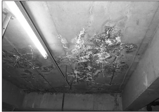
Détérioration dans la partie intérieure d'un plancher de garage de stationnement avant réhabilitation
