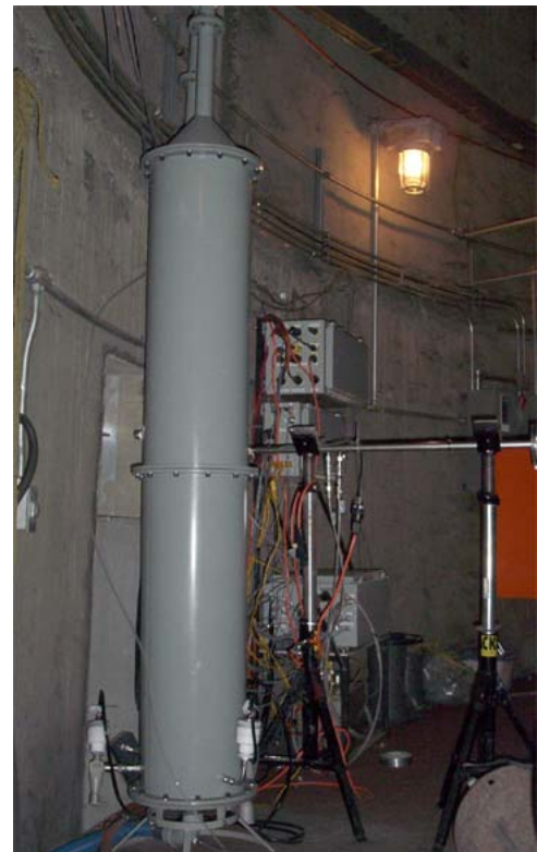
Système d'échantillonnage CETC-3 placé dans une cheminée
