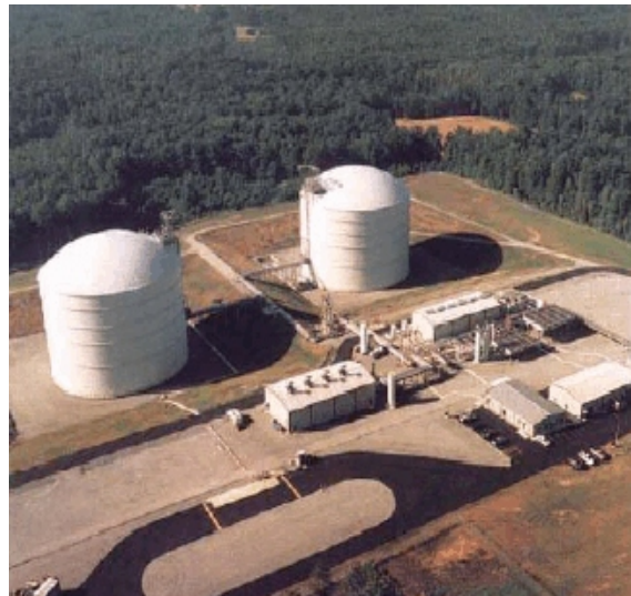
Installation de stockage de GNL pour l'écrêtement des pointes
