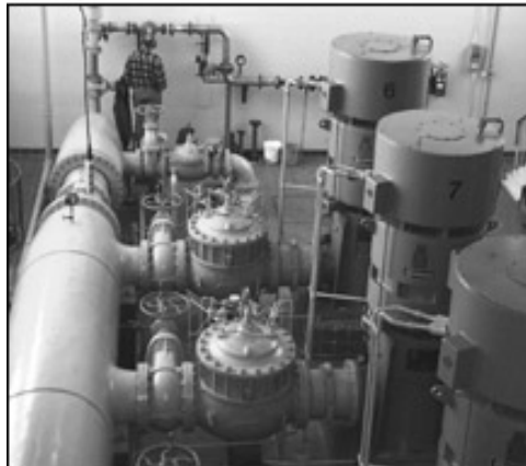
Salle de pompage eau traitée
