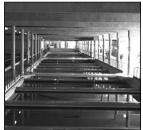
Salle de filtration d'eau
