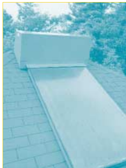
▲ Chauffe-eau solaire à thermosiphon à Camp Queen Elizabeth, île Beausoleil de la baie Georgienne, en Ontario. Gracieuseté de Solcan Ltd.
