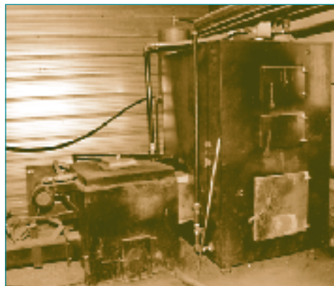
L'une des deux chaudières de 160 kW sur la ferme Schurman.
