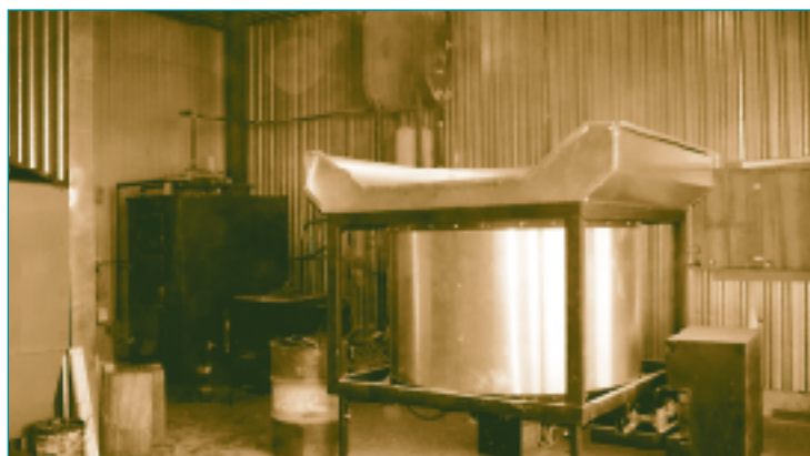
L'installation de chauffage et le prototype de réservoir intermédiaire.
