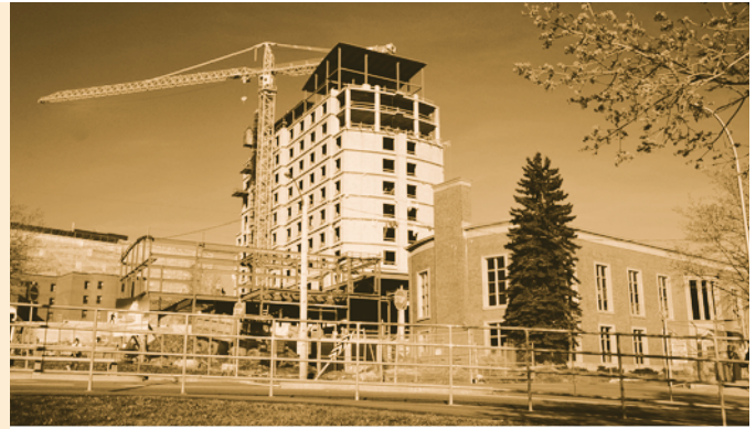
La construction d'un centre pour officiers et officiers mariniers a commencé l'an dernier à Stadacona de la BFC Halifax. CDC assure les services de passation et de gestion du marché.
