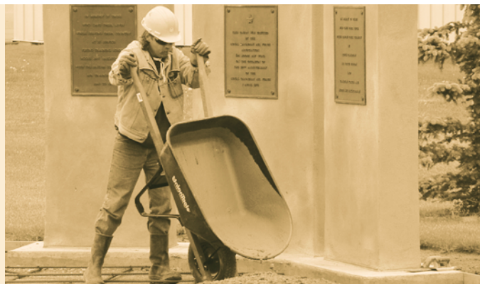
Dans le cadre de travaux généraux d'entretien à Bushell Park, en Saskatchewan, CDC assure la gestion des ordres de travaux exécutés par des entrepreneurs à offre à commandes. Ci-dessus, un entrepreneur construit un monument érigé à la mémoire des héros de la 15 e escadre Moose Jaw morts au combat.
