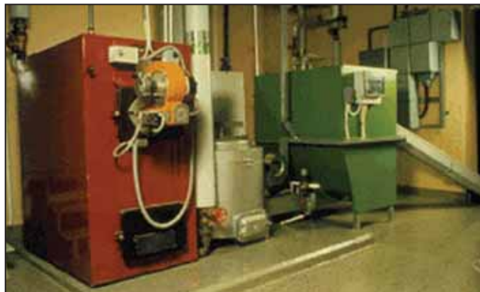
Figure 8 : Système de chauffage à la biomasse.
