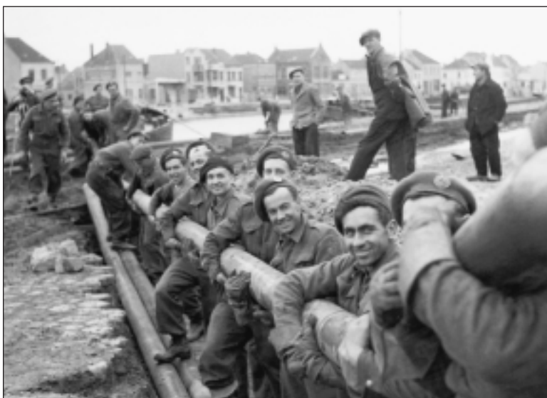
GRUPE DU CORPS DE GÉNIE ROYAL CANADIEN ABAISSANT UN TUYAU DANS L'EXCAVATION DE LA CHAUSSÉE, OSTEND, OCTOBRE 1944. (ARCHIVES NATIONALES DU CANADA 130263)
